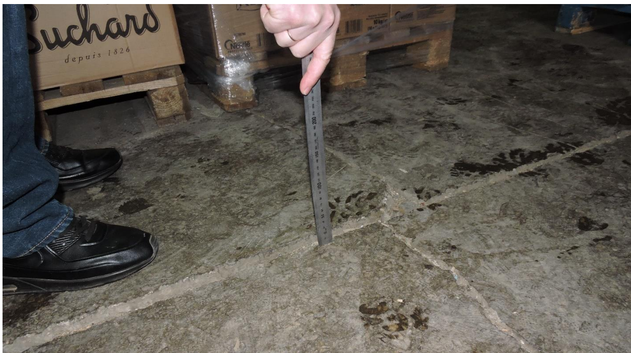
Рисунок 3.5. Трещины в полу глубиной до 45 мм
