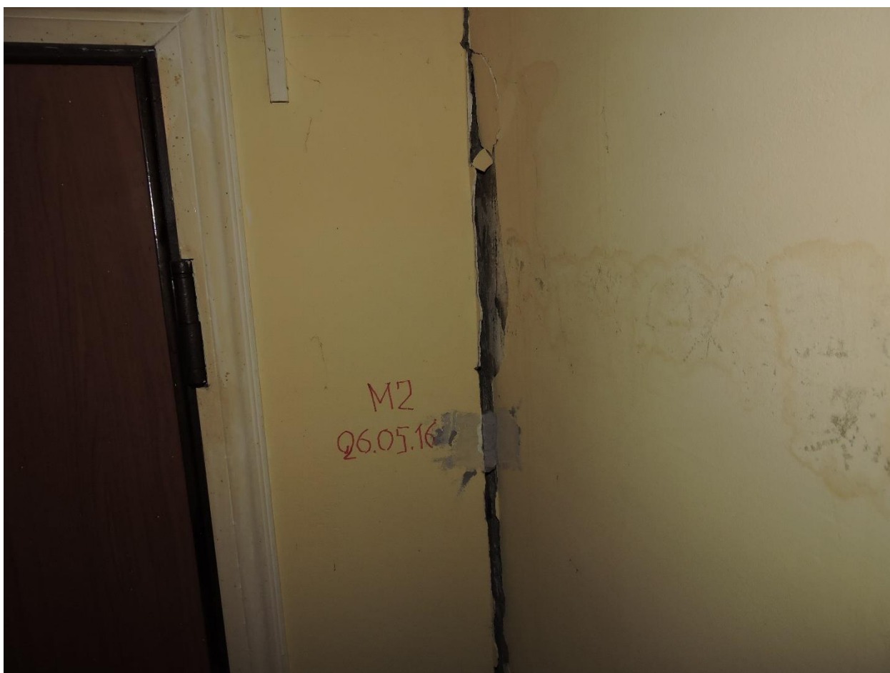
Рисунок 3.6. Трещины между стенами
