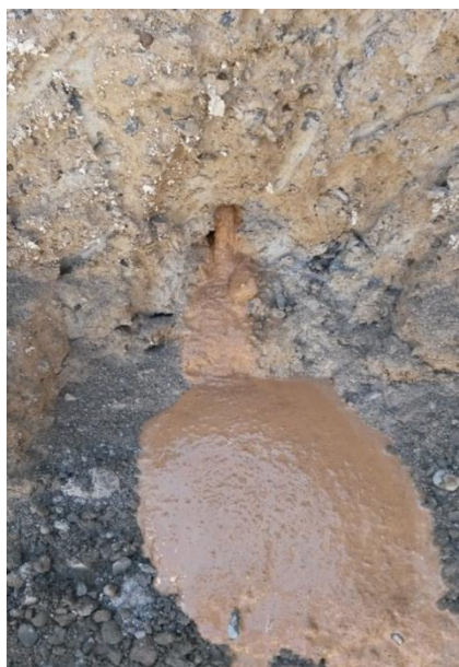
Рисунок 6 - Вынос песчаного грунта из скважины
