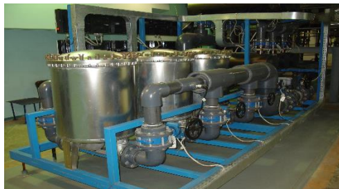
Рисунок 4. Установка химического опреснения.
