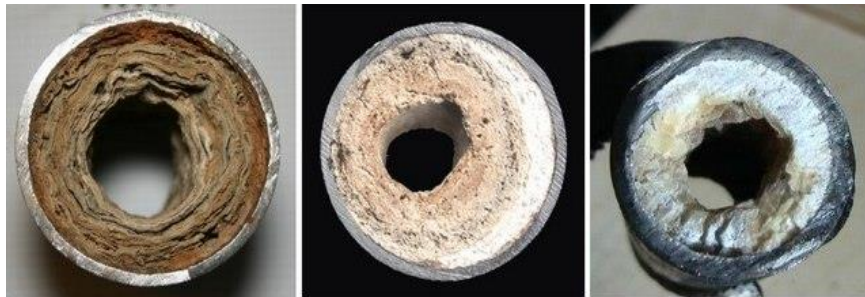
Рисунок 1. Отложения в трубах [4]
