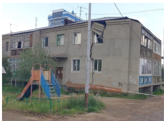
Рисунок 4 - Появление трещины в доме из-за накопления воды под зданием сооружения, г. Якутск, июнь, 2020 г.
