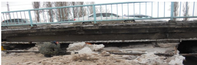
Рис. 2. Вид на зазор за мостом на пересечении р. Ала-Арча и ул. Льва Толстого, снятый с северной стороны моста. Как видно, анализируя ситуацию, близу под мостом работают двое сотрудников МЧС, (они мало заметны). один из них руководит, другой находится за крупным зазорным образованием
