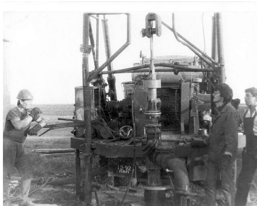
Рис. 3. Установка скважинного насоса с устройством беструбного водоподъема на объекте сельскохозяйственного водоснабжения [2]
