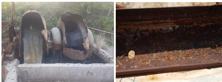
Рис. 3. Стальные конструкции. Видимые дефекты
