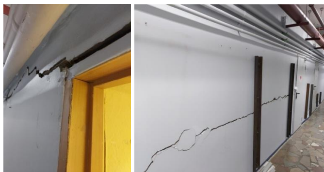
Рисунок 16. Трещины в здании Дворца культуры в г. Норильске, лето 2021 года
