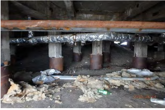
Рис. 3. Инженерные коммуникации в холодном пространстве под зданием.
