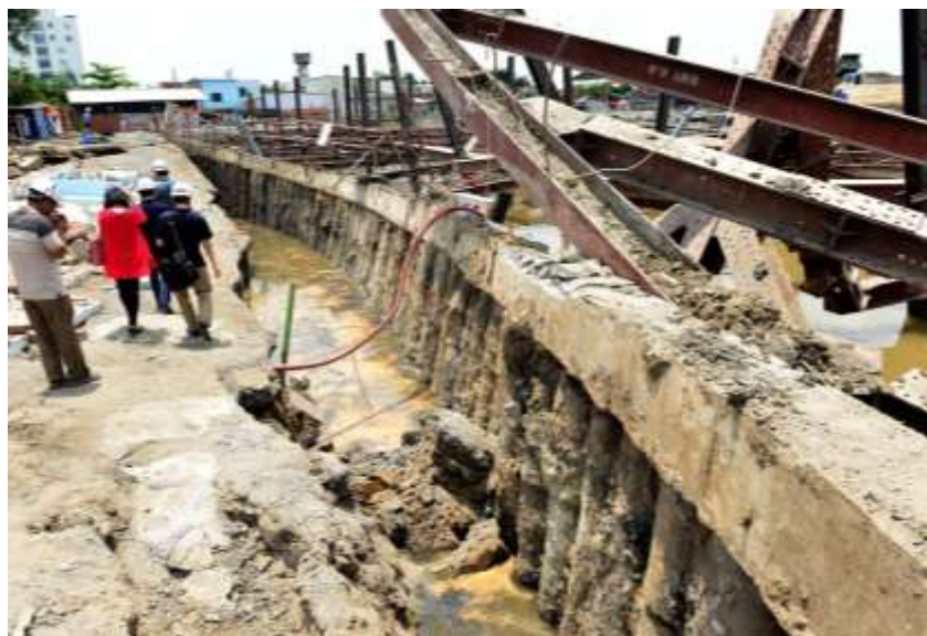
Рис. 3. Проседание фундамента в ходе строительства комплекса высотных зданий в городе Хошимин (Вьетнам)
