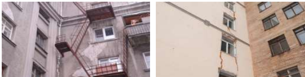
Рис.1. Общий вид образовавшейся вертикальной трещины поперек всей высоты здания с торца и с противоположной стороны.
