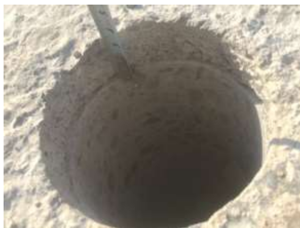
Фото 4. Вид шурфа с участка плиты, подверженной образованию расслоений в процессе монтажа
