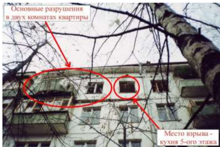
Рис. 2 Фотография последствий аварийного взрыва метановоздушной смеси в двухкомнатной квартире, расположенной на 5-ом этаже 5-ти этажного жилого дома.
