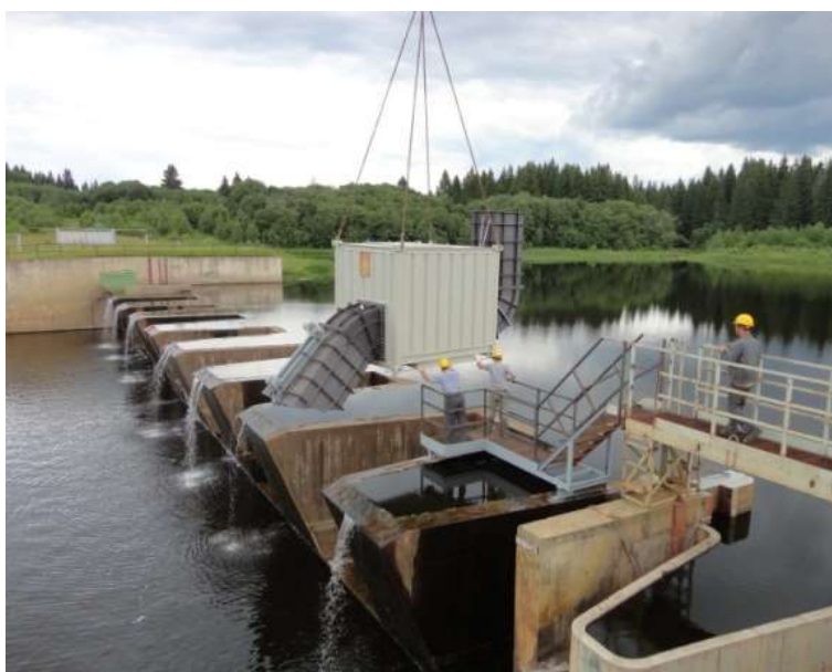
Рис. 1. Установка энергетического блока мини ГЭС на полигональный водосброс р. Нерль. Контейнерное исполнение с ортогональной турбиной в нижнем бьефе
