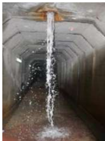
Рис. 2. Просачивание воды внутрь тоннеля под рекой Чань во Вьетнаме в 2012 г.
