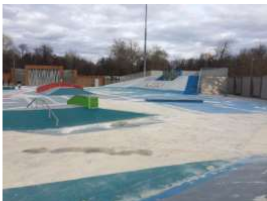
Фото 5. Вид плиты, подверженной образованию дефектов
