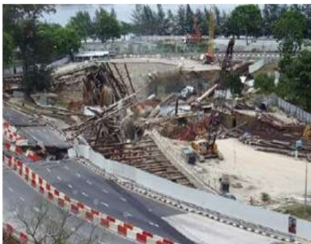
Рис. 1. Авария при строительстве метротоннеля в Сингапуре в 2004 г.
