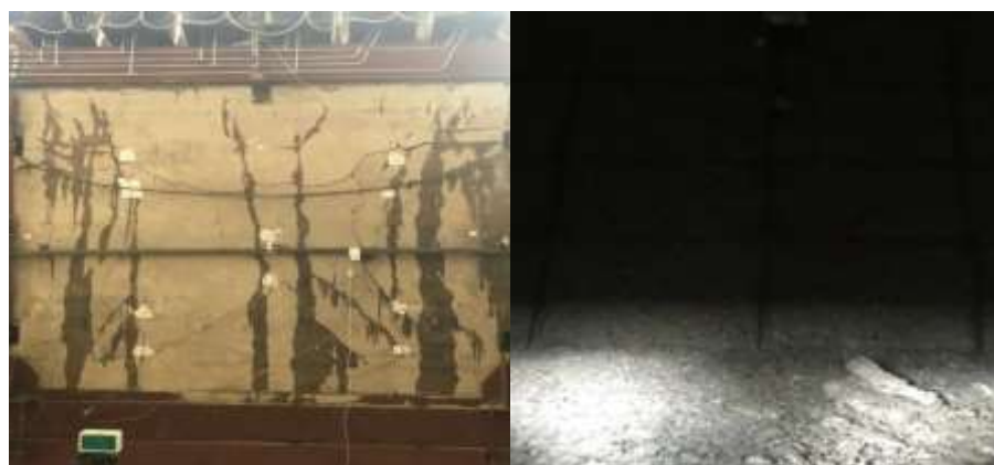
Рис.3 Иллюстрация трещин и осыпание бетона с поверхности плиты
