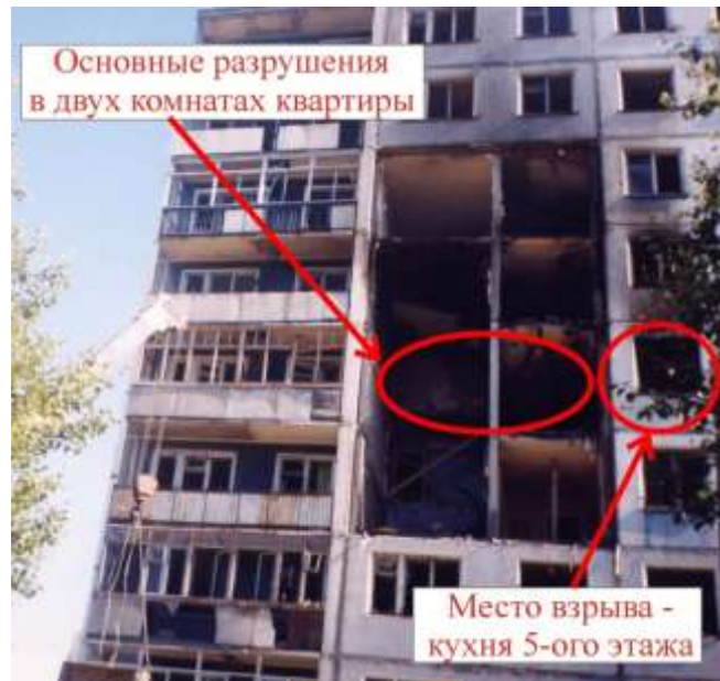
Рис. 1 Фотография последствий аварийного взрыва в двухкомнатной квартире, расположенной на 5-ом этаже 9-ти этажного жилого дома.
