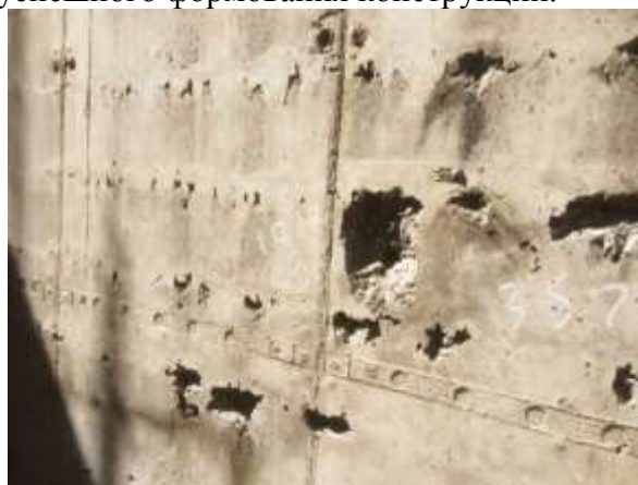
Фото 1. Вид стены, подверженной образованию раковин, в ходе бетонирования
