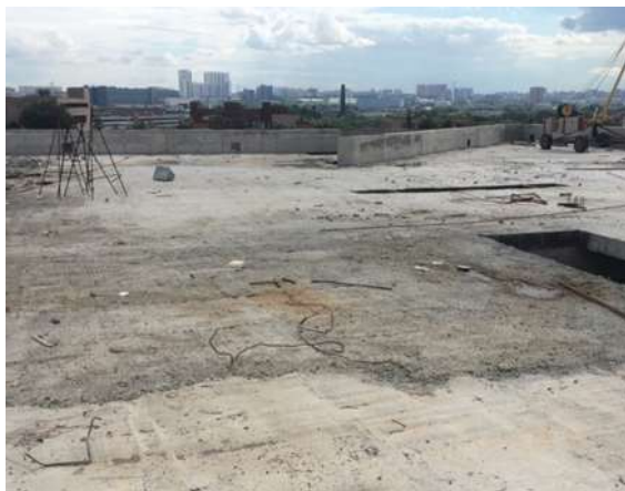
Фото 2. Общий вид плиты перекрытия на 28 суток. Изменение цвета, неоднородная структура
