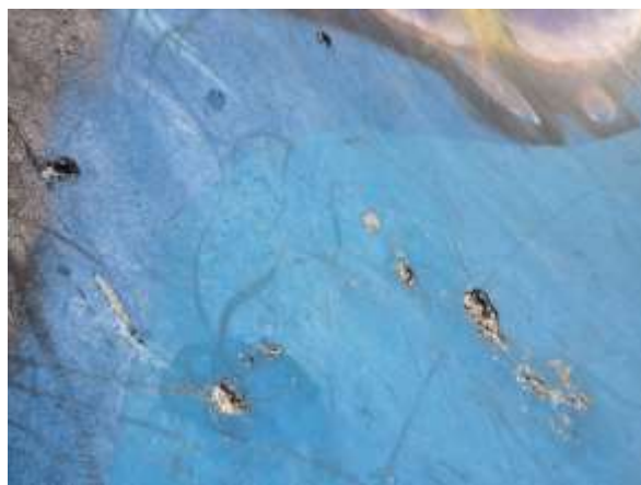
Фото 3. Вид плиты, подверженной образованию поверхностных раковин, в ходе эксплуатации
