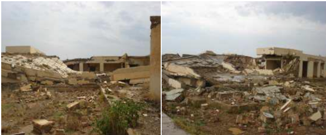
Рис. 1.8. Влияние террористических атак на строящийся объект [167]
