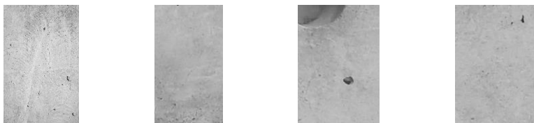
Рис. 1 «No cracks» (без трещин)
