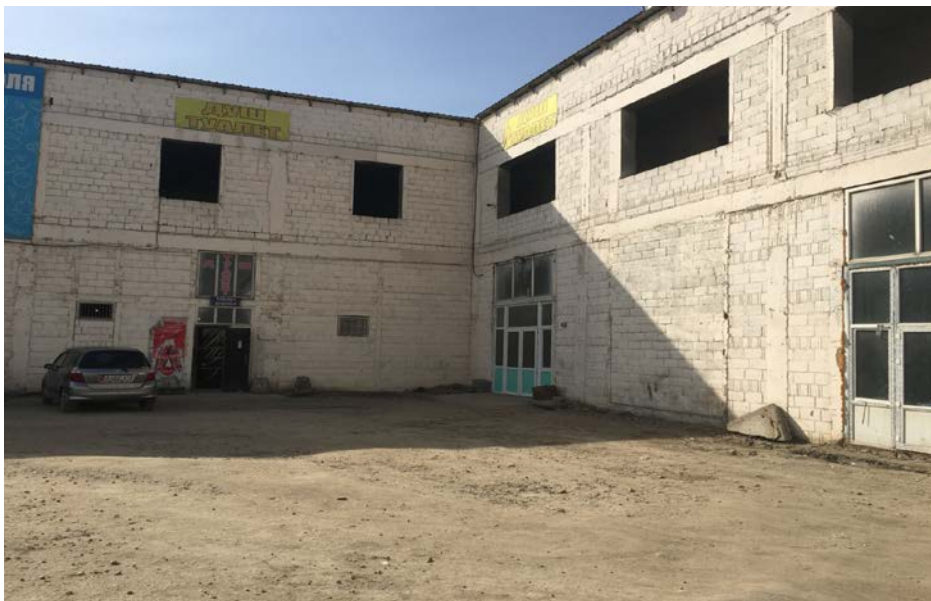
Рис 1. Угол здания. По температурному шву, по оси 3-4
