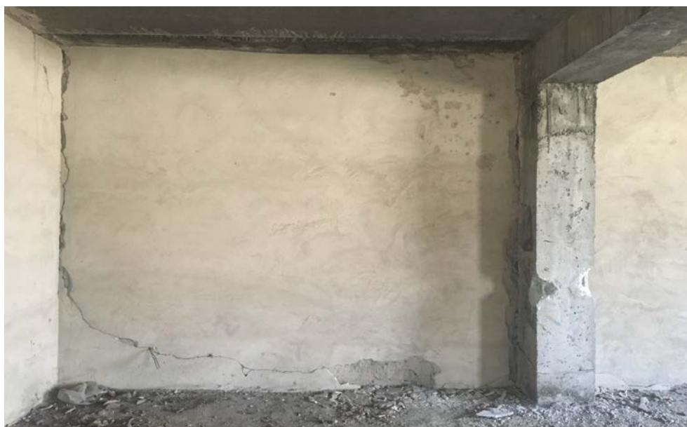
Рис. 6. Трещины (повреждения) в перегородках по оси 4
