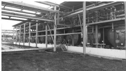
Рис. 1. Склад ЛВЖ и органических растворителей.
