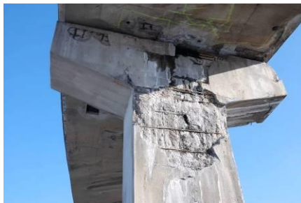
Рис. 2. Разрушение защитного слоя бетона колонны
