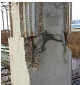
Рис. 1. Локальное разрушение колонны
