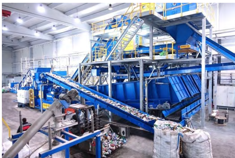
Рис. 6. Сортировочно-распределительный цех мусороперерабатывающего завода.
