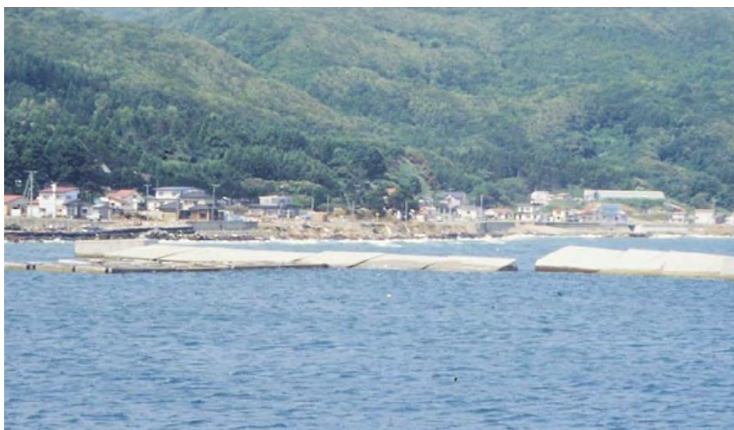
Рис.1. Разрушение фундамента волнолома вследствие цунами, Окусири, Япония, 1993 г.
