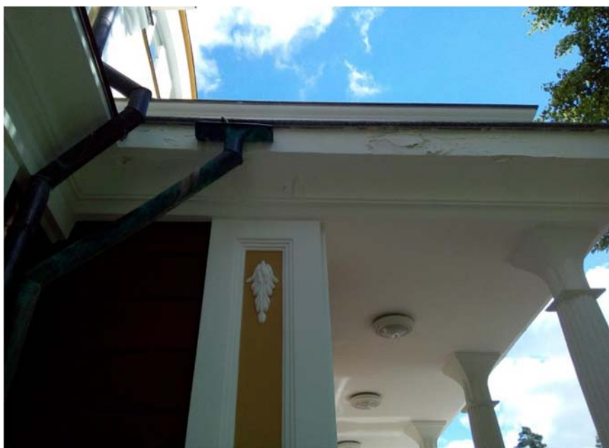
Рис. 2. Трещины, отколы штукатурного слоя
