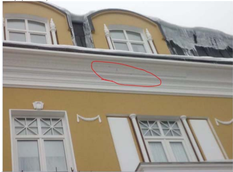
Рис. 5. Наледи на стыках стен мансардного этажа
