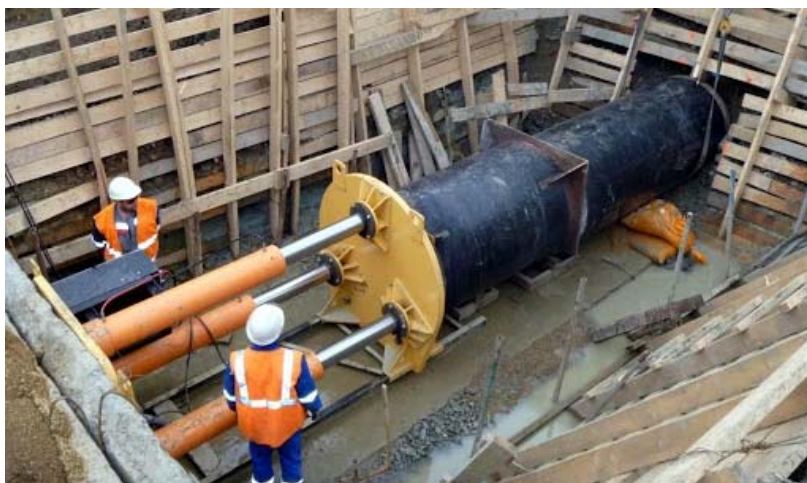
Рис. 1. Процесс производства работ по устройству трубопровода методом продавливания при помощи системы гидродомкратов
