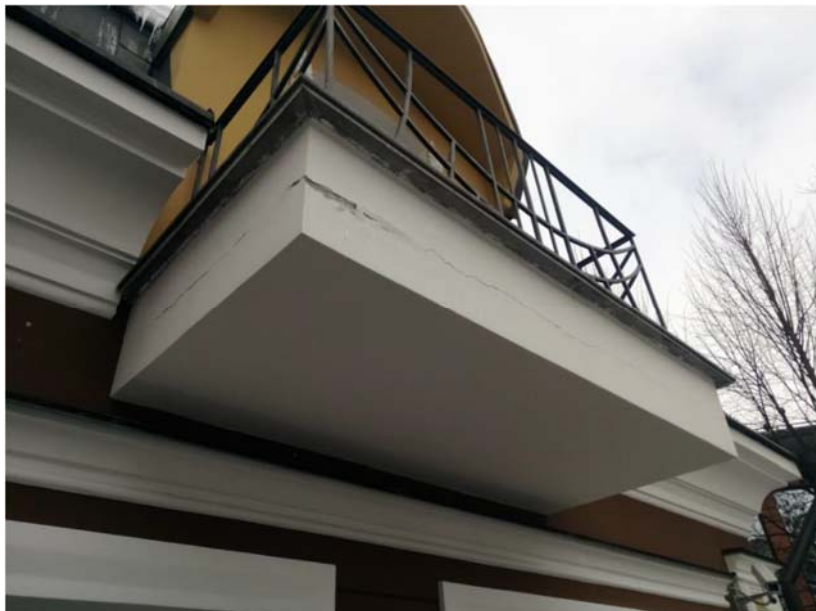
Рис.1. Деструкция штукатурного и декоративно-отделочного слоев
