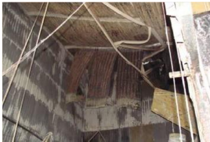
Рисунок 2 – Состояние конструкций покрытия после пожара
